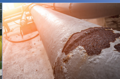
PREVENÇÃO DE CORROSÃO EXTERNA
